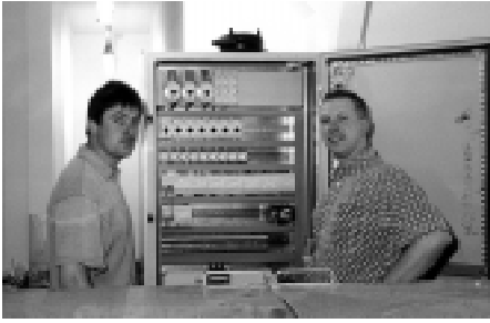
Blick auf die Kompaktsteuerungen.
